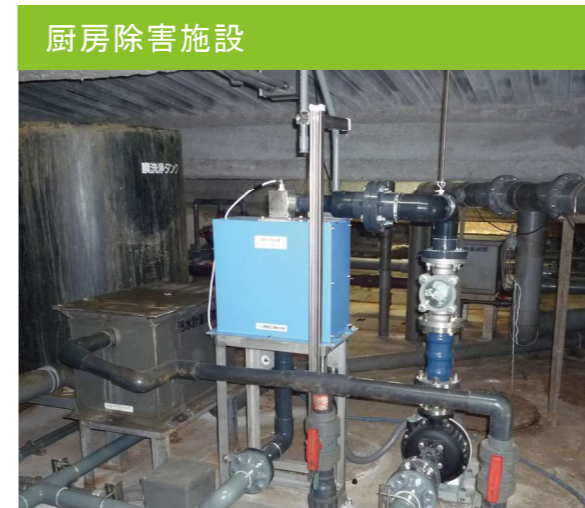
厨房除害施設
