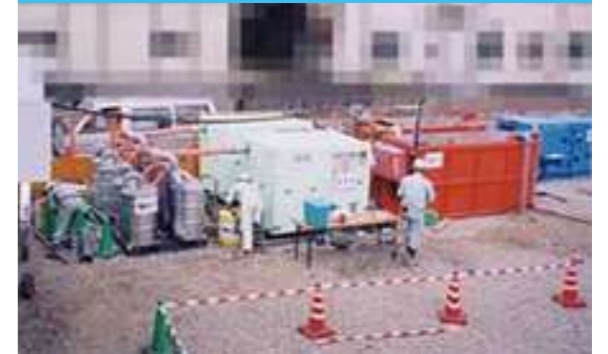
地下水揚水処理によるVOC除去
